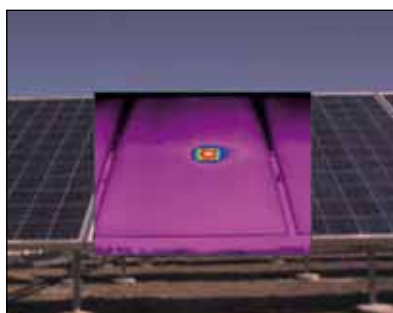
Panel fotovoltaico que presenta una celda defectuosa
