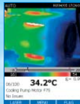
Bomba de refrigeración a temperatura de trabajo.
