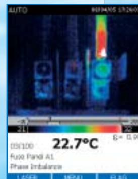
La diferencia de temperatura entre fases indica una carga no equilibrada.
