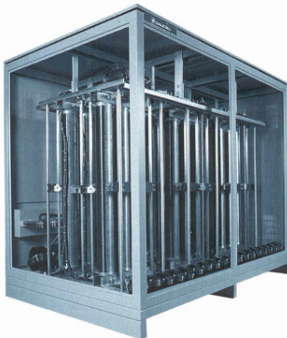
Equipo de 600 kVA con 12 salidas, utilizado en hornos eléctricos para la fabricación de cristal.
