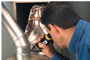
Endoscopio analizando interiores de tuberías
