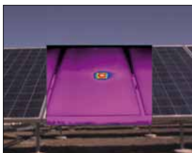
Panel fotovoltaico que presenta una celda defectuosa
